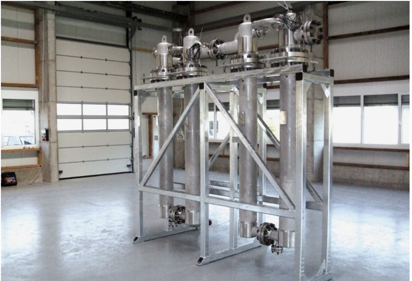
Scale Up einer Reaktionsanlage auf 4000 kg h -1
